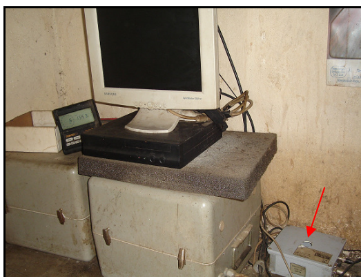
Fotografía 3. Equipamiento computarizado para registros de datos climáticos y sísmicos en sitio de interés.
