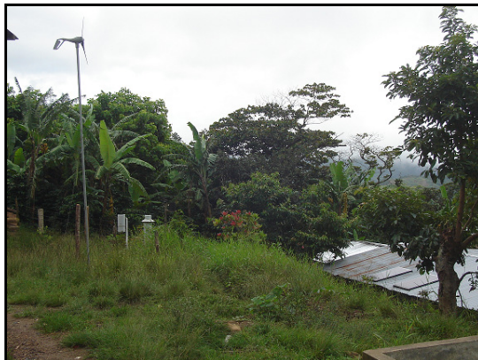
Fotografía 2. Se observa equipos y accesorios de la Estación Meteorológica Winzard III en Comunidad El Volcan. Entre estos, pluviógrafos, anemómetros, paneles solares, planta eólica, etc.
