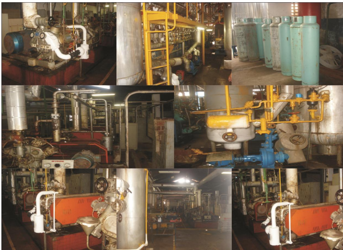
Figura 1 – Sistema Refrigeração, Sala de Máquinas e Compressor do Gás Amônia Fonte: Produção própria (2010)
