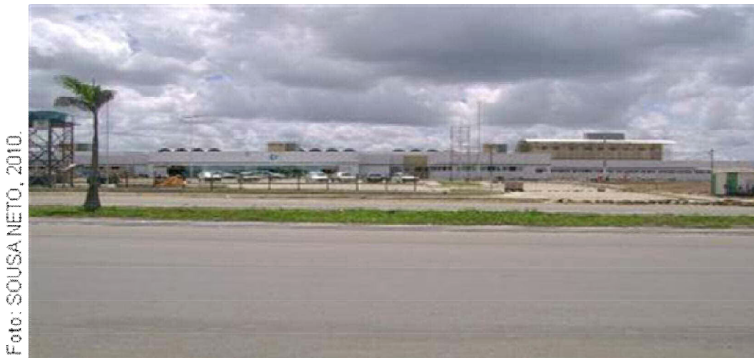
Foto 4 - Hospital de Traumas de Campina Grande, em construção às margens da Av. Mal. Floriano Peixoto
