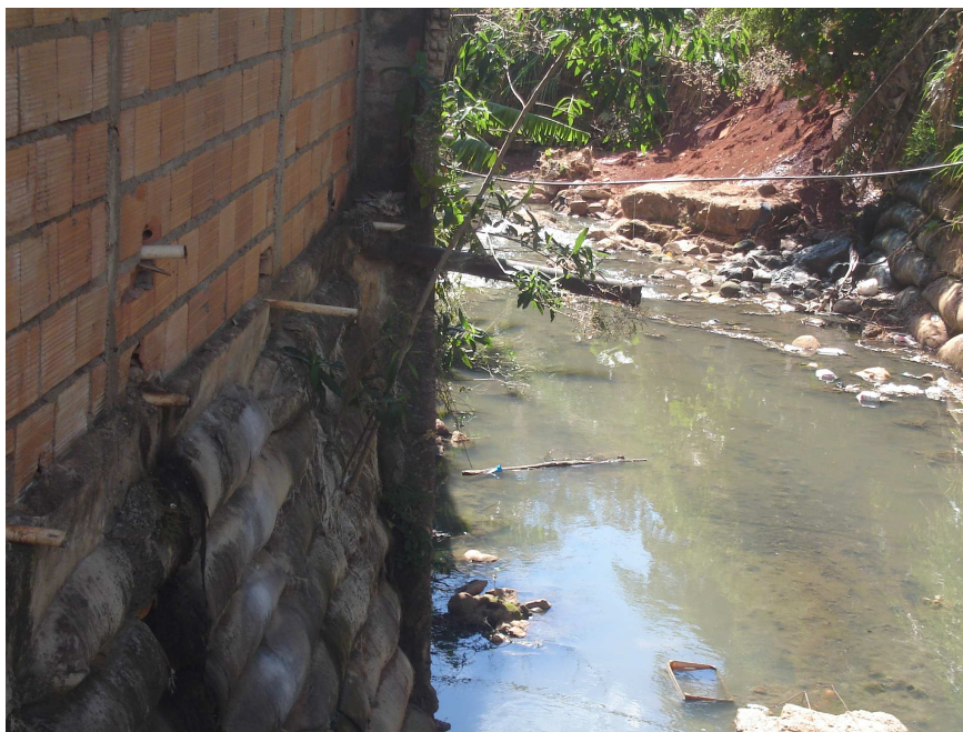
Figura 1: Tubulações de esgotos domésticos no Córrego Cercadinho
