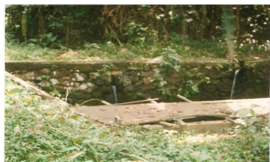
DEPOSITO DEL AGUA QUE VIENE DEL CERRO LA CONEJA UBICADA EN LA HACIENDA EL CAMBURAL. LA HONDA CARRETERA VIEJA HACIA ESCUQUE.
