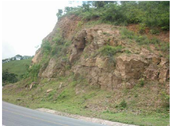
Foto No 3. Talud alto e irregular. Foto T. Obando
