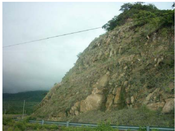
Foto No 2. Talud rocoso fracturado suficientemente alto. Foto T. Obando
