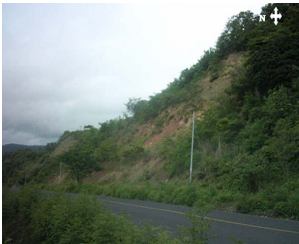
Foto No 5. Flujos de detritos en pared de corte de carretera, suficientemente alto e inclinado. Foto T. Obando
