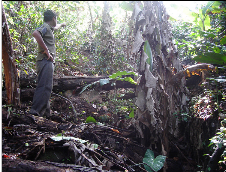
Fotografía 7: Se aprecia en esta imagen efectos ocasionado por deslizamientos ocurridos en la propiedad Sra. María Jarquín. Se presentan árboles y troncos tumbados, acumulaciones caóticas de macizos rocosos y suelos arcillo-arenosos.
