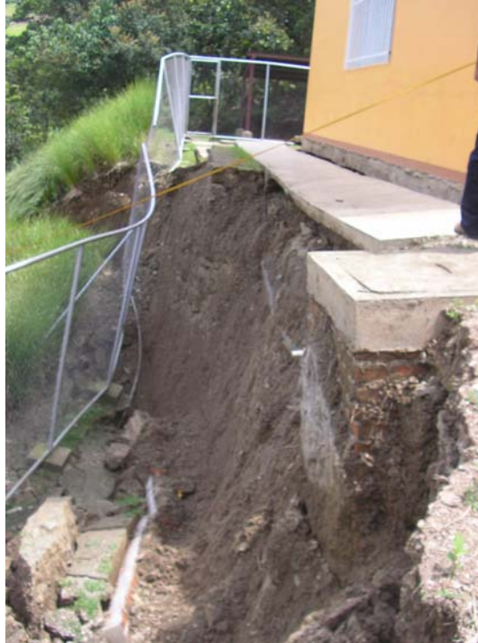
Ilustración 3. Escarpe circular de deslizamiento de tierra en costado Sur de Centro de Salud
