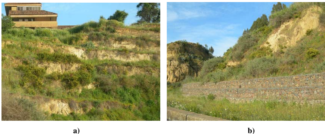
Ilustración 9. a) Bio-ingeniería, hilera de arbustos y/o grama de baja altura dispuesta en escalón paralelos al frente de talud espaciada vertical como horizontalmente menos de 2m. b) Muros de gaviones con disposición horizontal y escalonada al pie de talud revestido de malla metálica en cuyo interior se encuentra bolones de formas casi redondeadas y tamaño pequeño.
