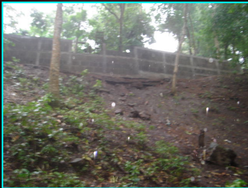
Diseños constructivo inadecuado incentiva la socavación de bases de muros en la construcción para ciertos lugares del borde Sur de Laguna Apoyo
