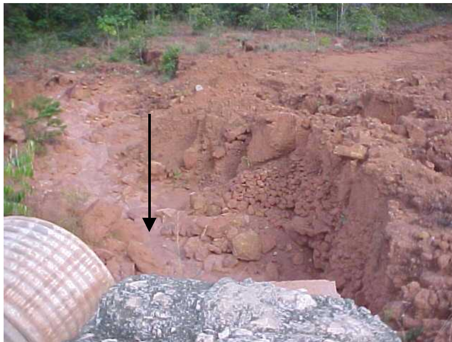
Foto 21. Socavación de fondo “longitud en (m) de canal con socavación de fondo: 17 m” (Caño El Chorro).
