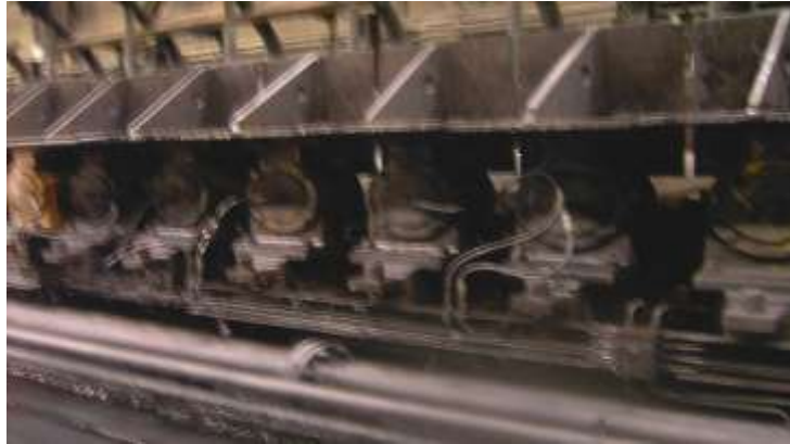
Tuberías, mangueras e irrigadores
