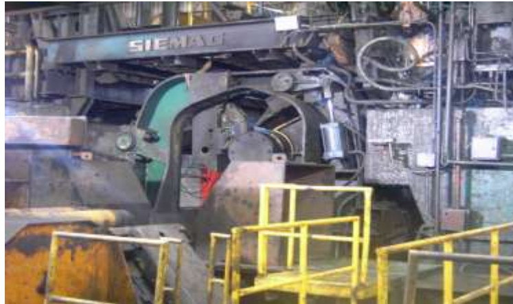
Camisas Presoras, Mangueras y Tuberías de Lubricación
