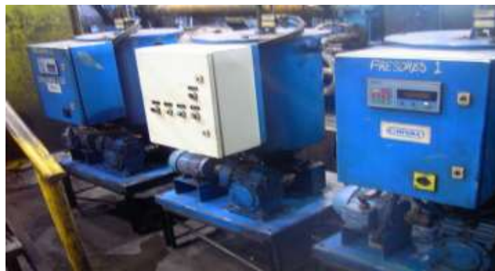
Sistema Neumático de Accionamiento de Rodillos Presores Enr #1, 2 y 3
