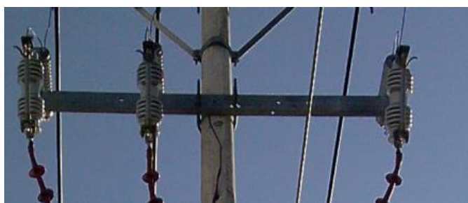
FIGURA 4" Portafusibles instalados en aisladores".
