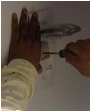
FIGURA 6" Interruptor en oficina de bodega 5"
