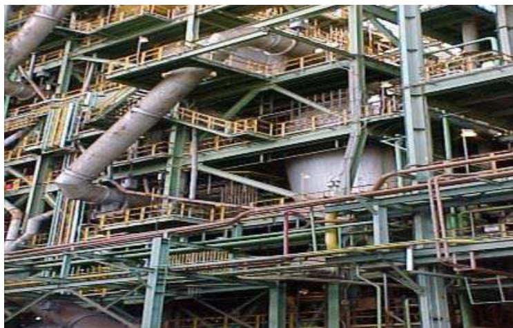
Figura N° 2: Área de reactores.
