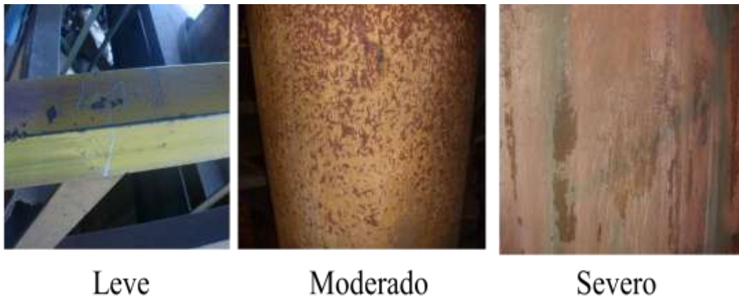
Figura N° 12: Clasificación de la falla por desprendimiento.
