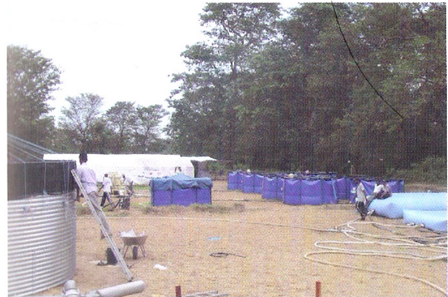
Planta depuradora de agua para abastecer de agua a la población damnificada. Emergencia
