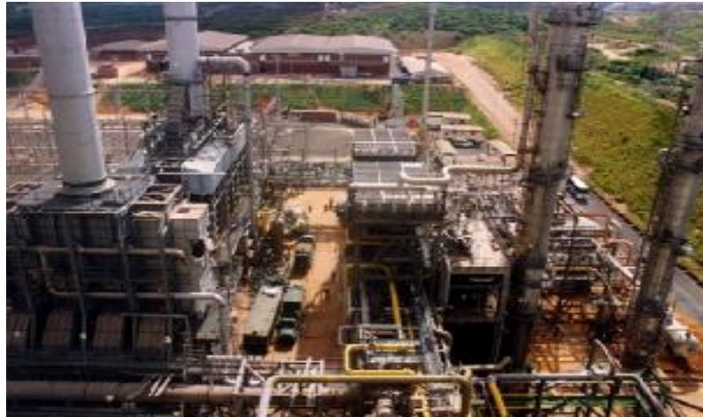
Figura 8. Área de planta de gas.
