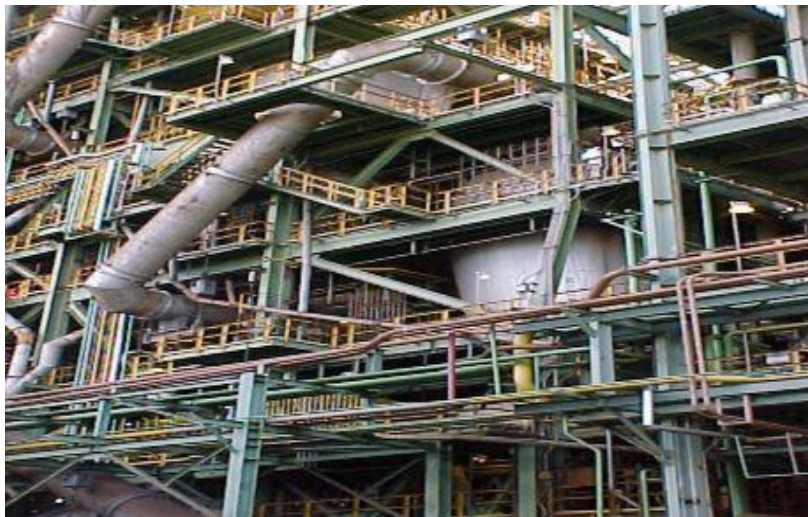
Figura 4. Área de reactores.
