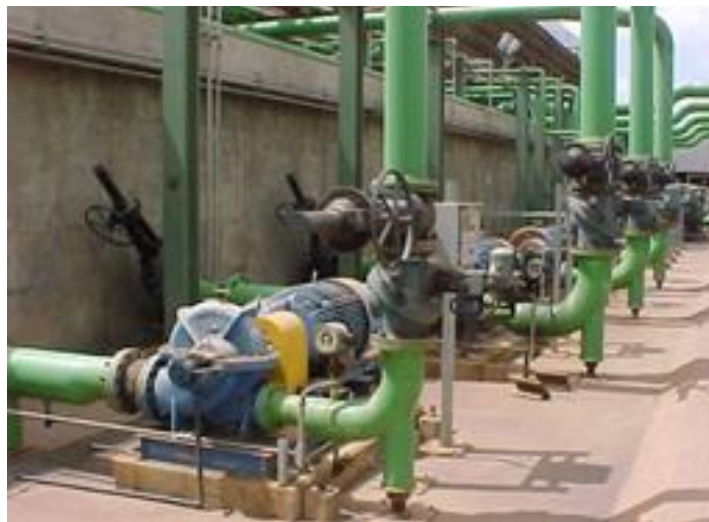
Figura 6. Sistema de tratamiento de agua.
