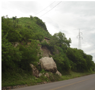
Ilust. 4 Derrumbe de Roca en Talud de Carretera Estelí hacia Condega en Foto T. Obando, 2008
