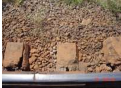
FALTA DE FIJACIONES
