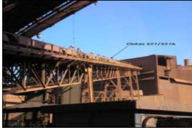
Cinta transportadora de materiales hacia Preparación y Molienda
