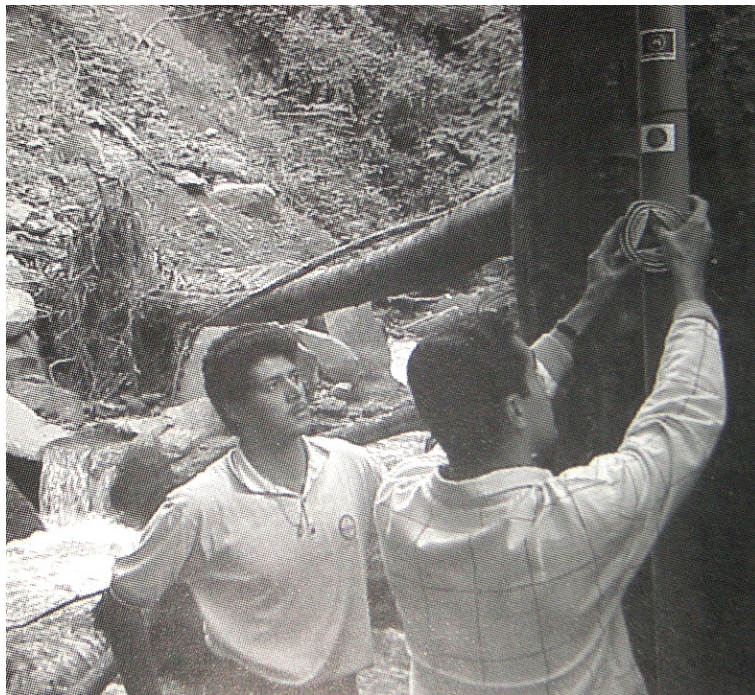
Sensor eléctrico para medir crecida del río
