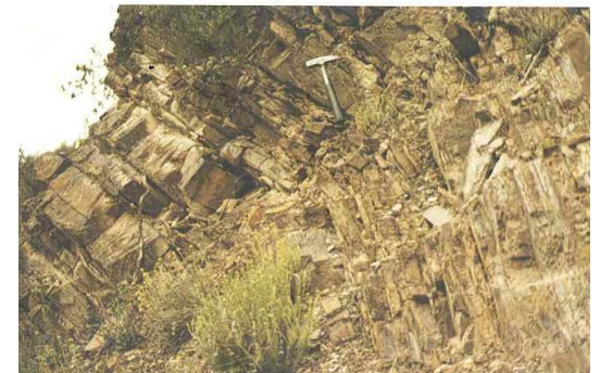
Bloques rocosos de un talud que han sufrido proceso de vuelco (foto L. González de Vallejo).
