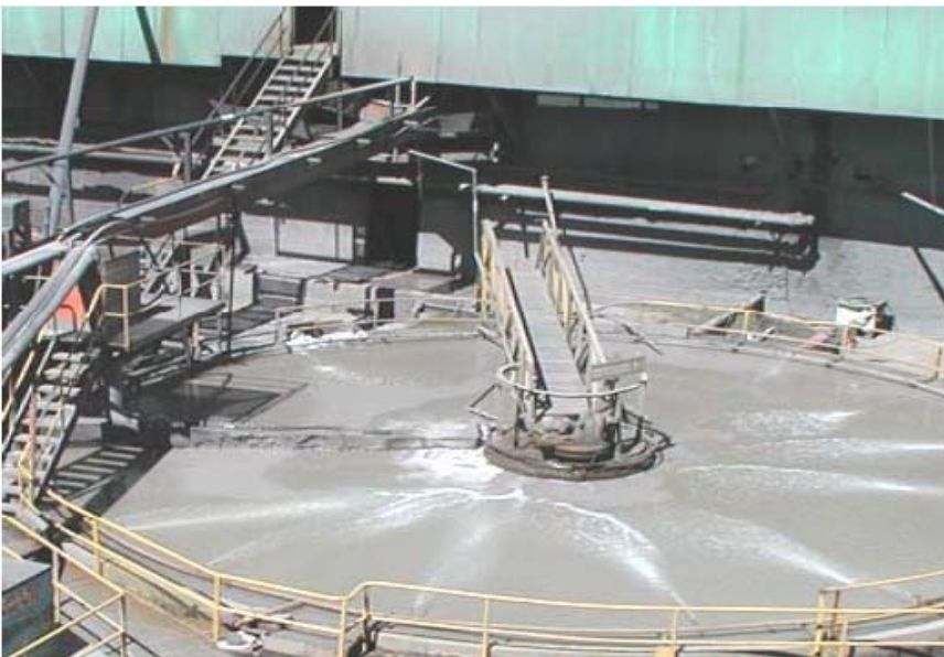
Fotografía N° 19: La eliminación de agua en el concentrado de Zinc se realiza en los espesadores, con la ampliación de la planta concentradora solo se repotenciara los espesadores para darle mayor eficiencia.
