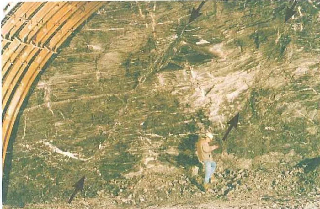
Fallas afectando al frente de excavación de un túnel en pizarras de clase IV (cortesía de M. Trimboli).
